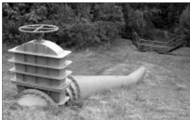
Tolózár az Atkai szivattyútelepen (Fotók: ÁFO, VÖO)
